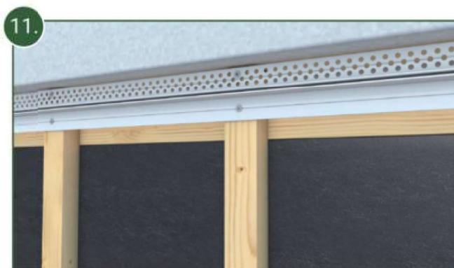
11. Visser, dans la rainure prévue, la partie inférieure du profil de ventilation (BAR_PV) sur la partie supérieure de la façade.
